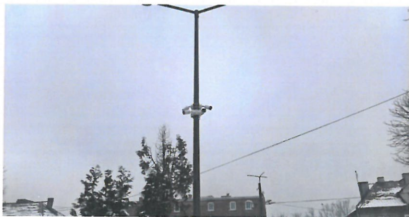
Fot. Zainstalowany monitoring
